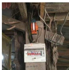
▲ 危険な配線箇所
