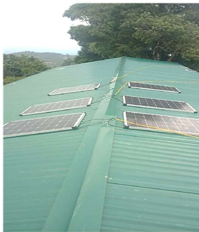
▲ 屋根の上に設置された太陽光パネル
